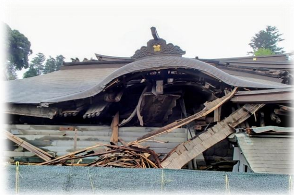
地震で全倒壊した阿蘇神社楼門
