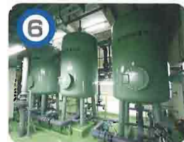
6 ↑活性炭吸着塔
