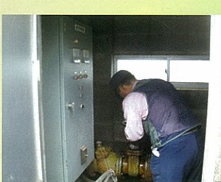
配水操作（用水管理人）
